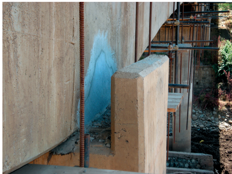
● Fig. 13 - Riparazione sulla pila centrale. ● Fig. 13 - Repair work on the centre pier.
