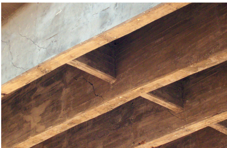
● Fig. 4 - Le fessure a taglio sull'impalcato. ● Fig. 4 - Shearing cracks in the deck.
