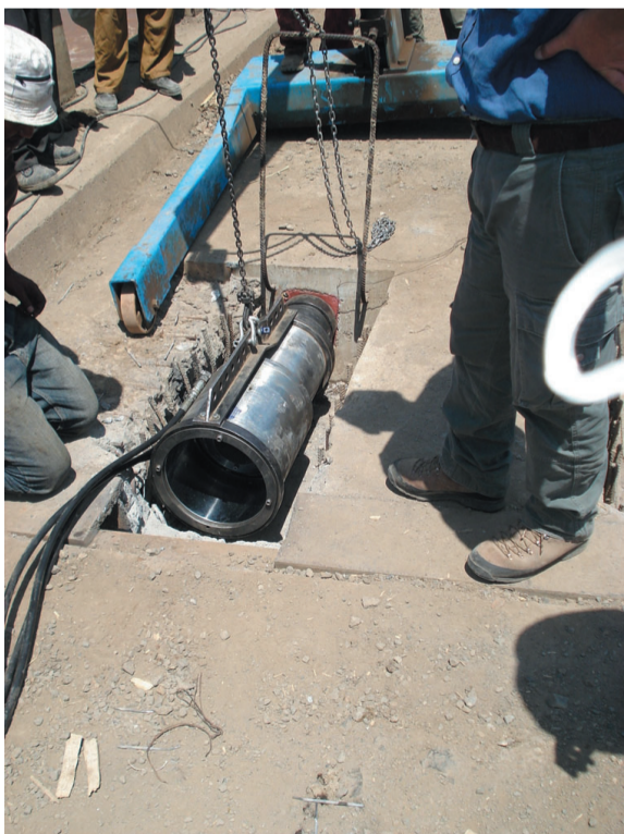
● Fig. 7 - Gli ancoraggi in soletta. ● Fig. 7 - Anchorages in the slab.
