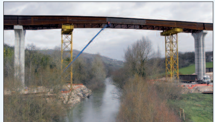
Figura 14 - Operazioni di serraggio dei bulloni sul concio di chiusura del Tammaro II
