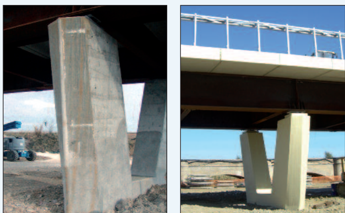
Figura 6 - L'effetto della verniciatura delle pile su i viadotti in Corten. Il ponte sul Sangro
