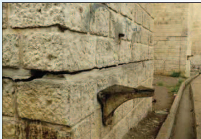
Рис. 4. Широко раскрытые трещины в основании тела промежуточных опор
