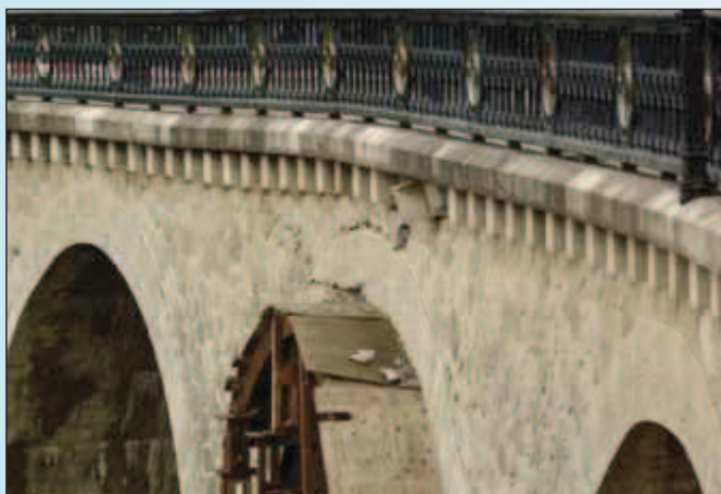
Рис. 3. Разрушение внутреннего пояса арки между опорами 4 и 5
